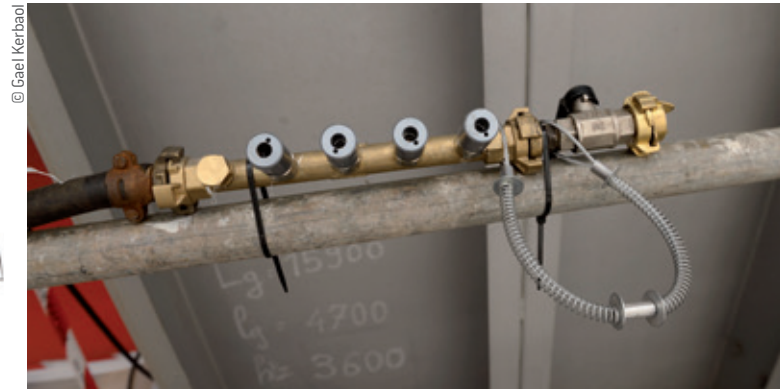
(Rampe pour alimentation en air comprimé)
